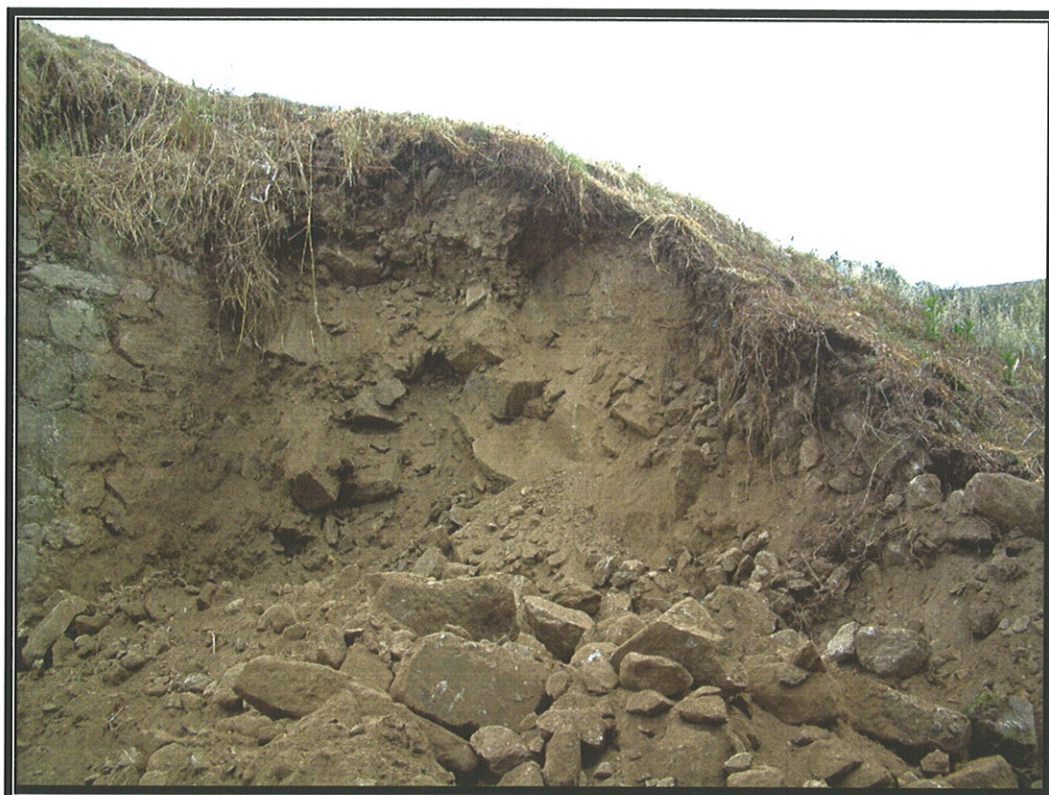
Vista do derrube que cubría á barbacá e ao bastión.
