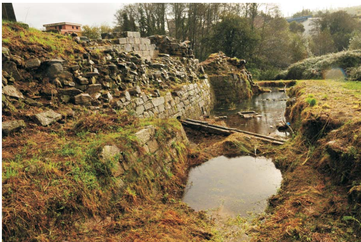
Vista xeral da zona exterior Sur. A drenaxe e saneamento deste sector do castelo era unha actuación de urxencia a realizar dada a súa situación de deterioro.
