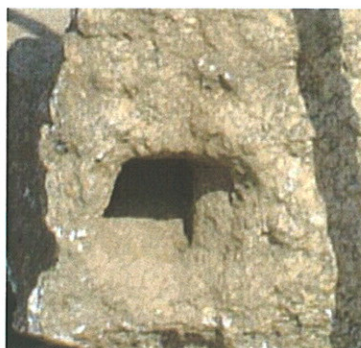
Detalle do desaigue de saída da bañeira.
