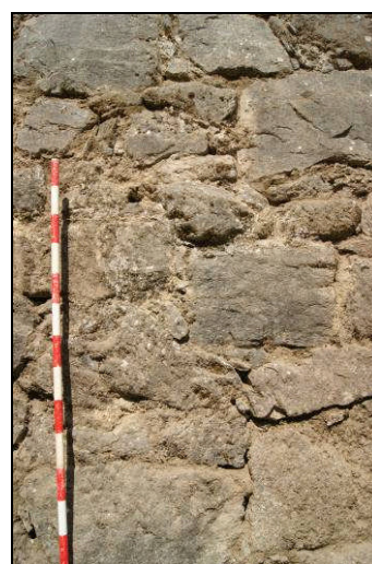
Restos de reboco de cal no lenzo exterior na zona sueste. Dende o sur.
